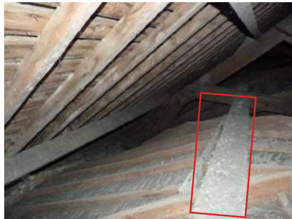
Une présence d'infiltration sur la charpente de la nef
