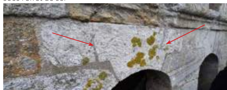
Fissuration d'une pierre de taille en linteau
