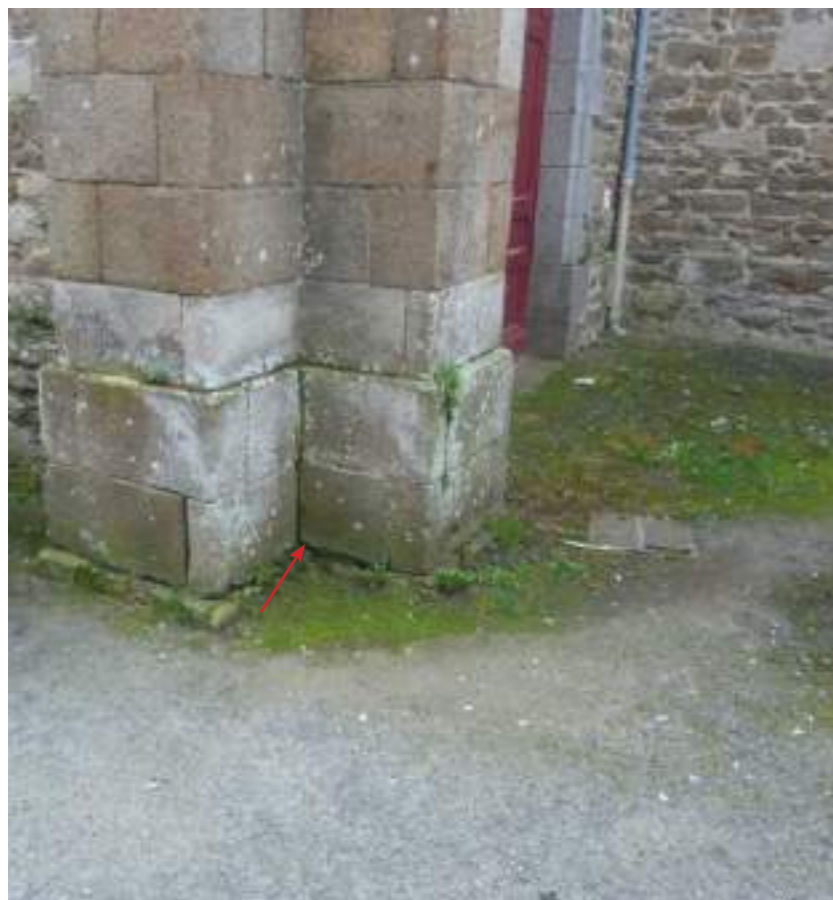
Côté nord de l'église. Présence de la remontée capillaire et joints lacunaires
