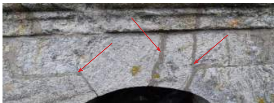
Fissurations multiples d'une pierre de taille en linteau
