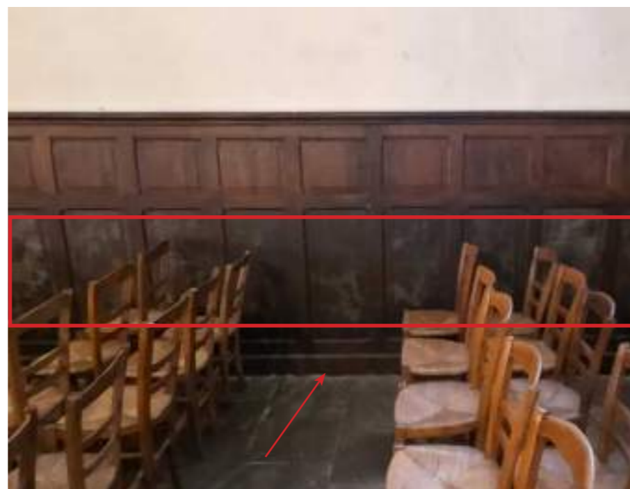
Des tâches blanches présentes sur le lambris du bas-côté sud et sur les dalles de granit, marquant les remontées capillaires présentes
