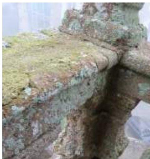
Le côté nord du clocher. Forte présence de mousse, révélatrice d'une présence d'eau stagnante
