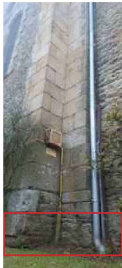
Le côté sud de l'église. Absence de joints
