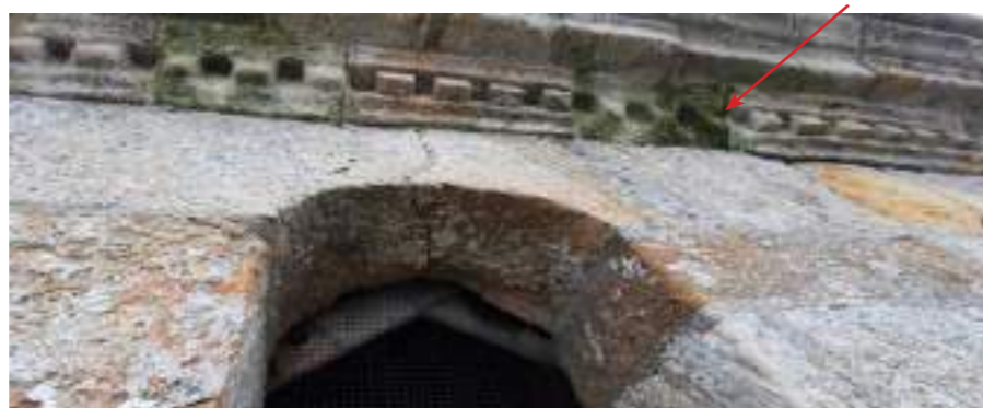
Le côté sud du clocher. Desquamation des pierres de tailles en modillons au droit de la corniche
