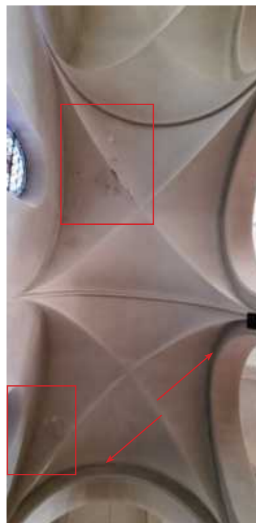
Présence des fissures et des écailllements de la peinture sur le bas-côté sud-ouest
