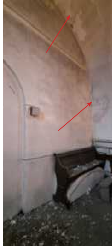
Présence d'humidité et décollement de la peinture
