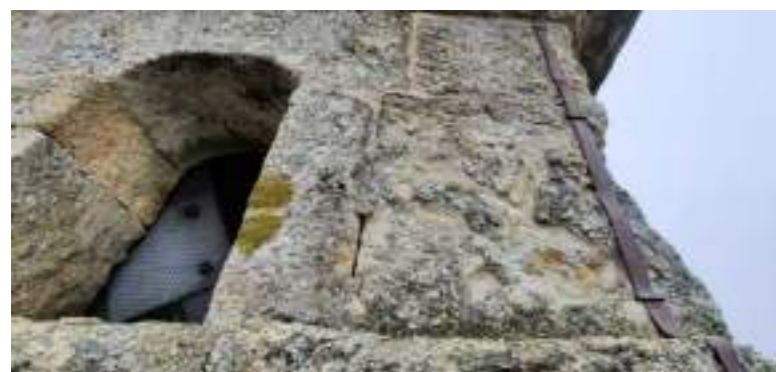
Le côté sud du clocher. Desquamation des pierres granit sous l'effet du sel
