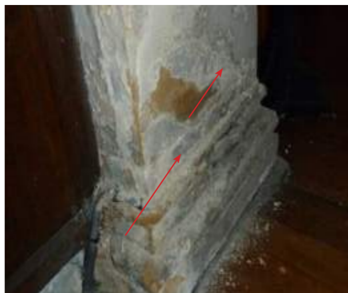
Présence de sel sur la base du pilier, due aux remontées capillaires
